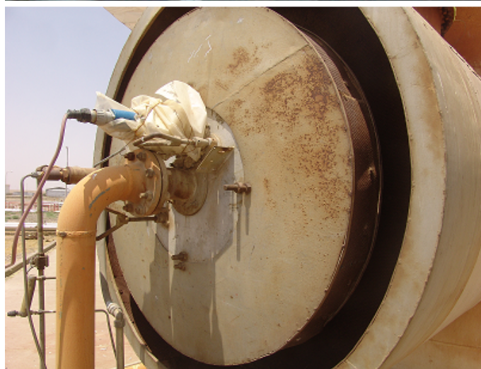
شکل ۹-۱ نمایی از محل نصب مشعل زباله سوز و سیستمهای اندازه گیری
